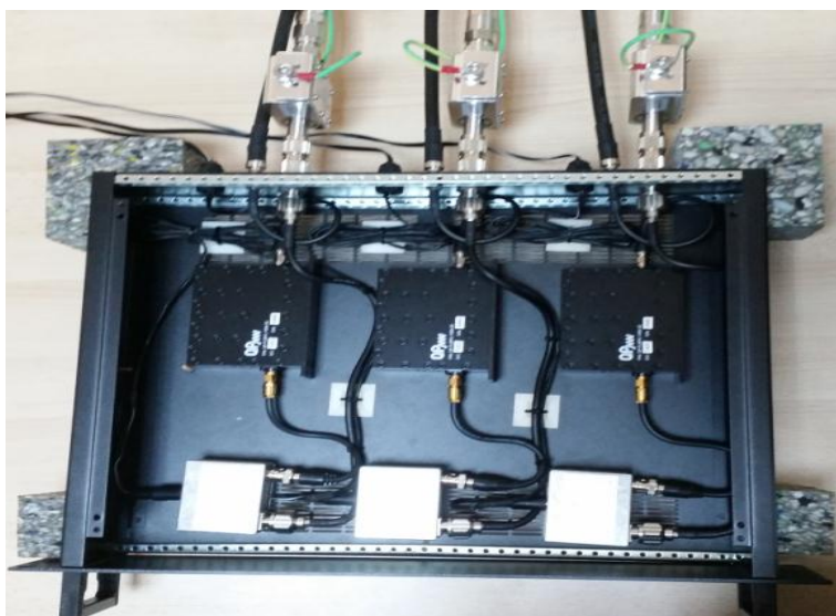
Vue intérieure du boîtier RF
